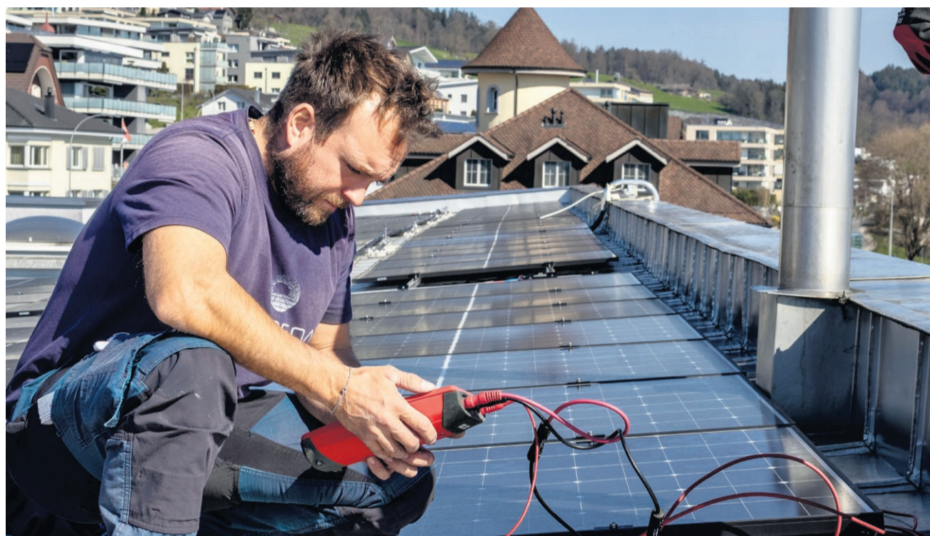
Wartungsarbeiten der Ohmstaler Lumena AG an Solarpanels in Wauwil. Foto Hubert Stäger
